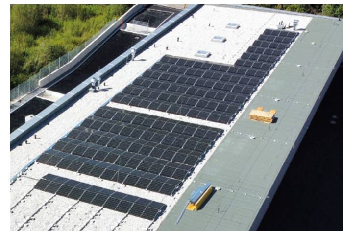
Bürgerkraftwerk am Dach des Feuerwehrhauses
